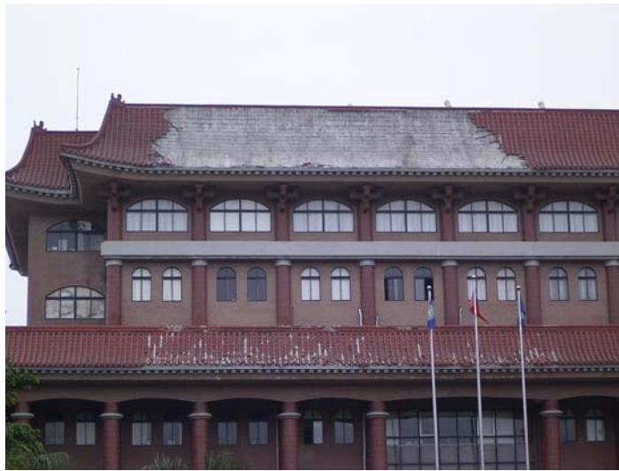
圖 4：屋面破壞形成
